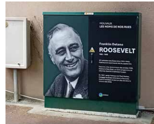
Armoires de rue
